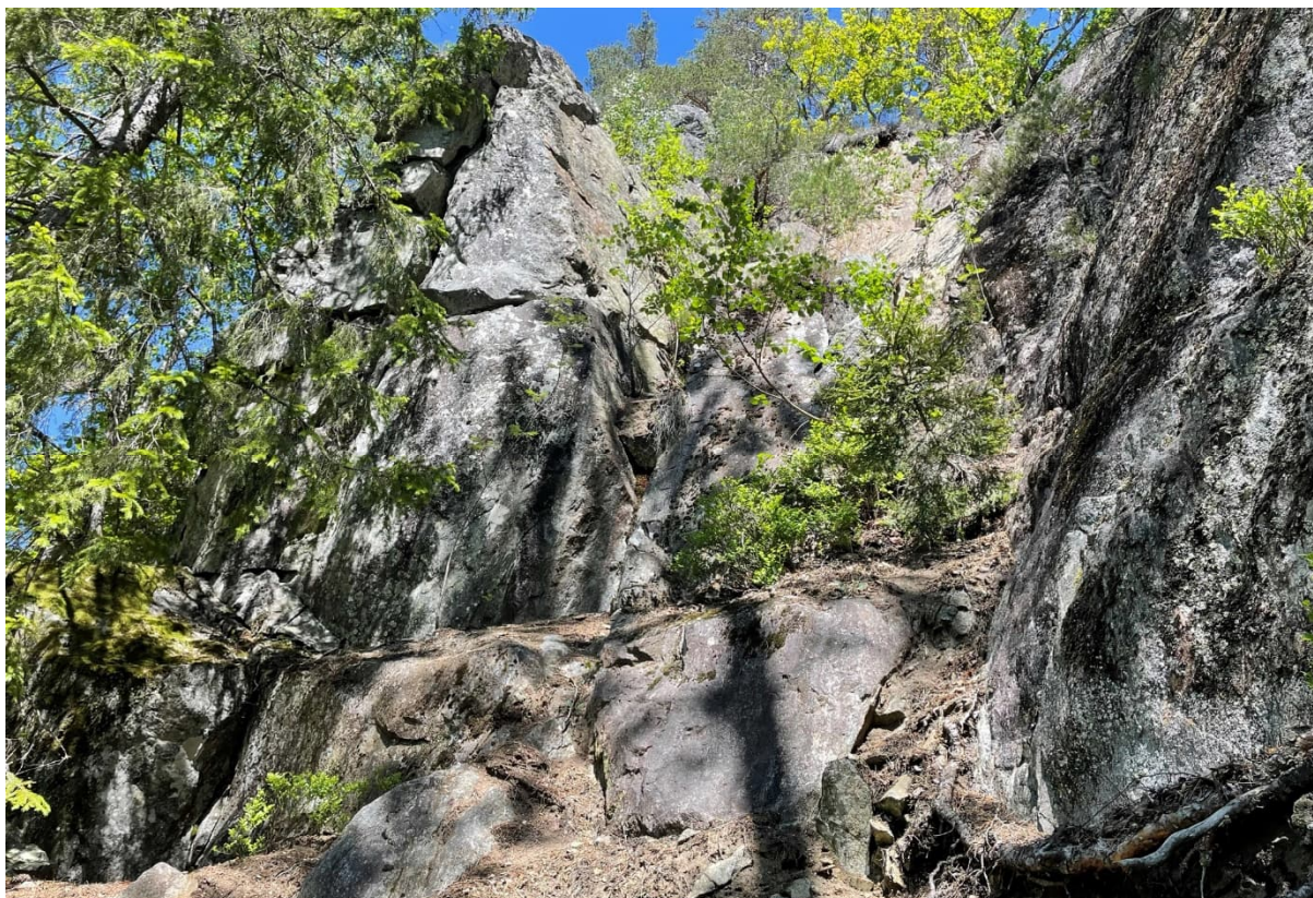
Figur 9-3: Bergskrent øverst i skråningen som ligger til venstre (nordøst) for sidevei 62540 som urmassene har løsnet fra. Fotograf Ingvild Sangesland Qvist.
