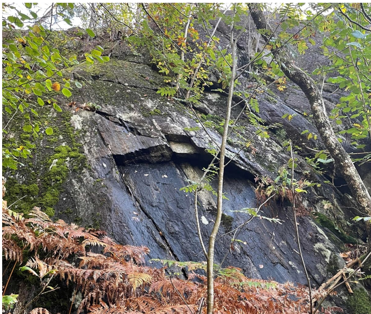
Figur 11-4: Avløste blokker i bergskrent rett i overkant av planlagt bergskjæring på venstre side av hovedveien ved profil 12235-12250. Sett mot øst. Fotograf Ingvild Sangesland Qvist.
