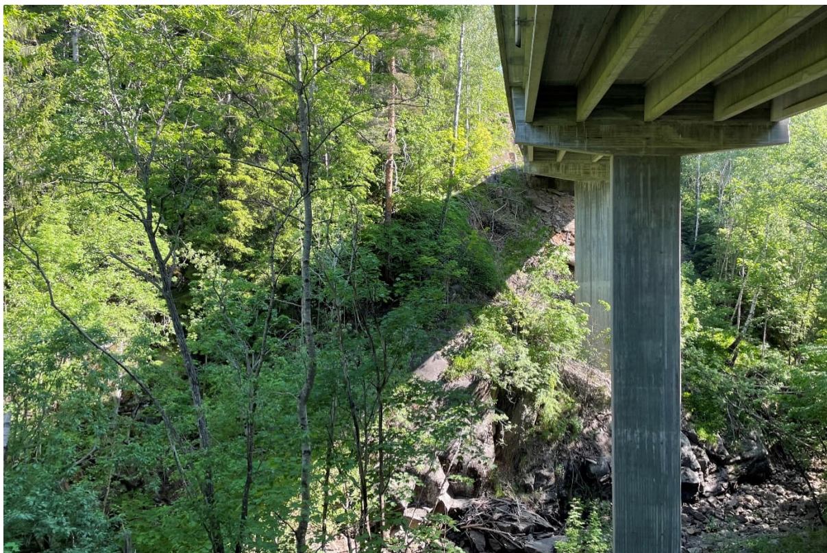
Figur 7-3: Under eksisterende bru over Tyvannselva, ved ca. profil 6400. Ny bru for vestgående løp kommer rett til venstre for denne. Sett mot nord. Fotograf Ingvild Sangesland Qvist.
