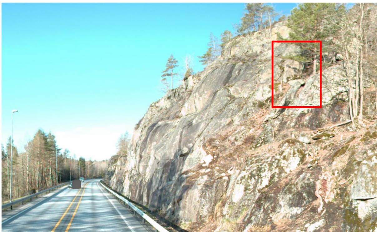
Figur 10-3: Vegbilde fra [8] som viser bergskjæring/sideterreng langs dagens E18 ved ca. profil 11135-11140 (venstre side sett med stigende profilering). Det er observert avløste blokker innenfor rød firkant (se nærbilde i Figur 10-4). Sett mot sørvest.
