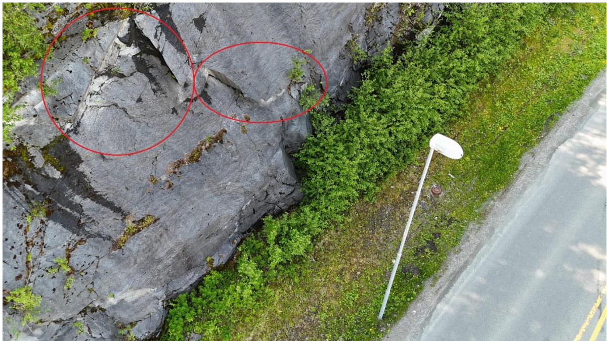
Figur 13 Antatt kile til utfall i bergskjæringen.
