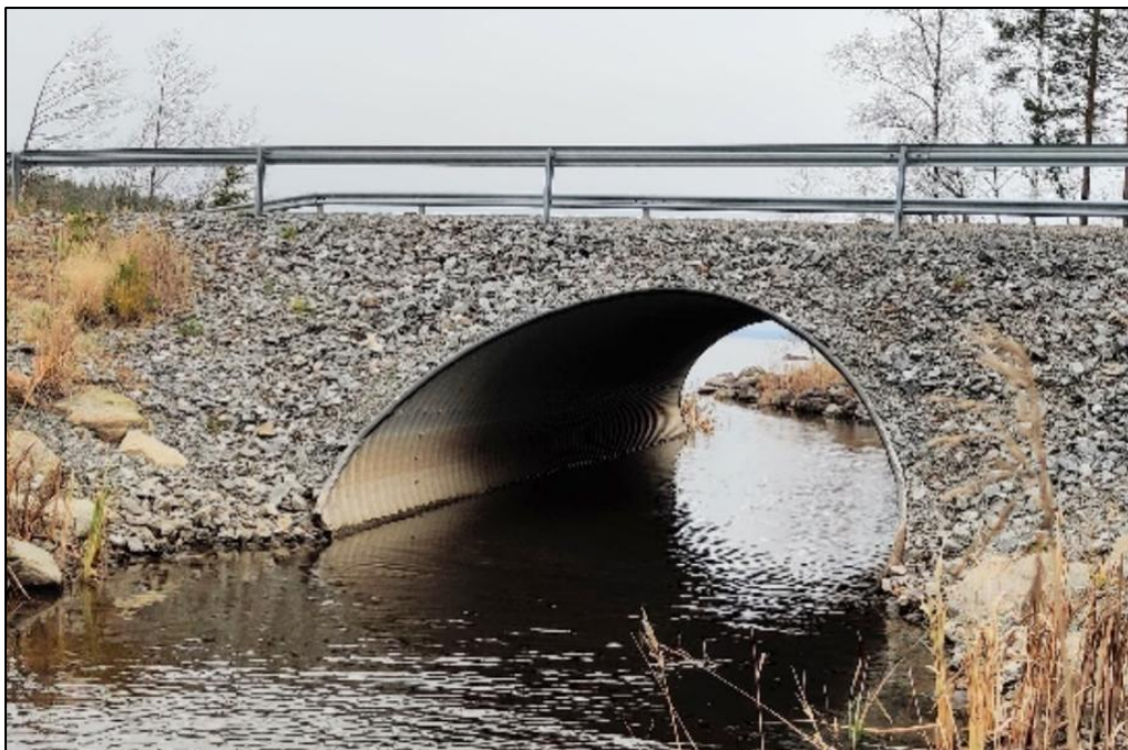
Figur 3-54: Ved kryssing av mindre bekker og elver kan løsninger, som vist her, også benyttes. Løsningene skal ivareta flom, med bunnsstrat for fisk og erosjonssikring (Kilde: Sweco).
