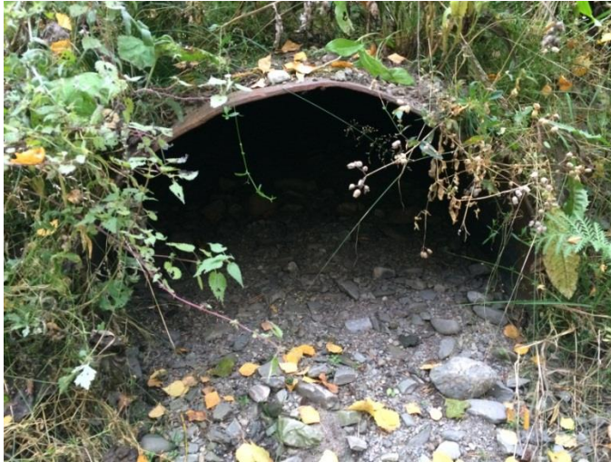
Figur 25 Kapasitet på stikkrenne under E6 og Dovrebanen er betydelig redusert pga grusmasser i røret.
