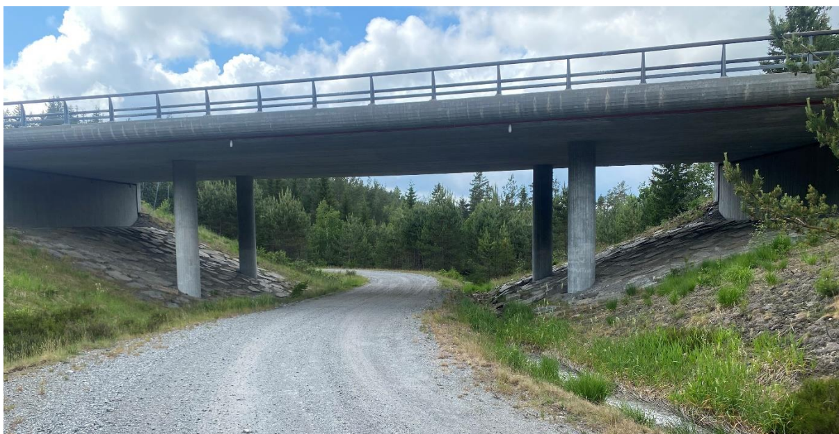
Figur 5-10. Faunapassasje under bru på dagens E18 ved Nærsumyr. Passasjen er mye brukt av hjortevilt.. Foto: Sweco.
